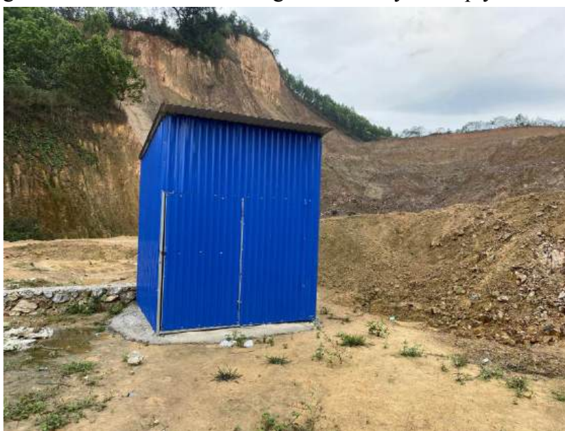
Hình ảnh kho chứa CTNH trên công trường đã được xây dựng
